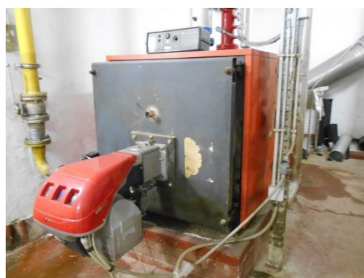
Figura 4.13 - Particolare della caldaia
