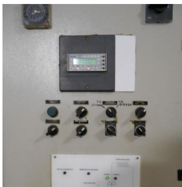
Figura 4.9 - Particolare della centralina di controllo dell’edificio
