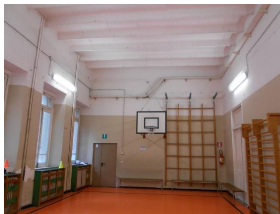
Figura 4.17 - Particolare dei corpi illuminanti ubicati nella palestra
