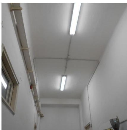
Figura 4.16 - Particolare dei corpi illuminanti ubicati in un corridoio
